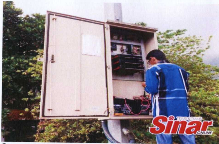
Seorang kakitangan Jabatan Meteorologi Malaysia membuat pemeriksaan pada alat penggera amaran tsunami di Kampung Nelayan Kuala Kurau, petang kelmarin.
